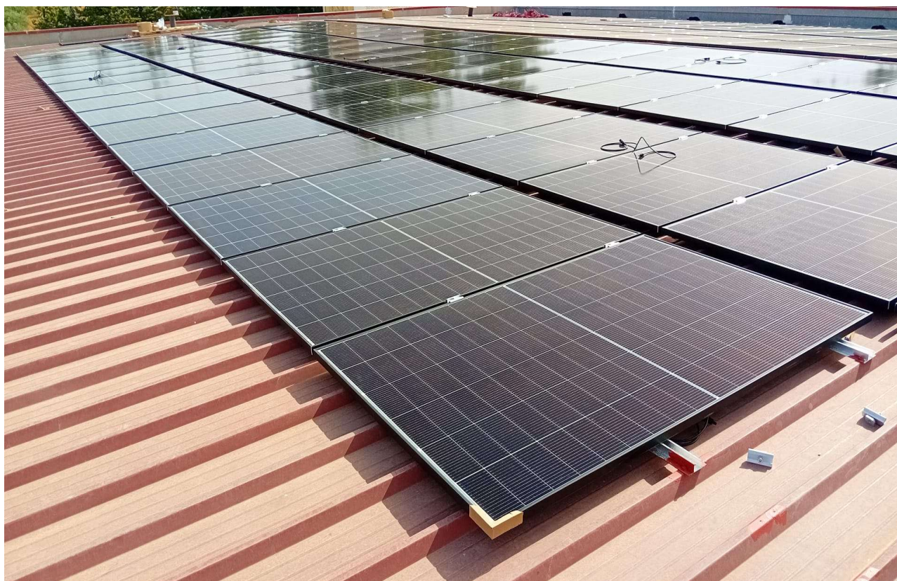
Nuovo Impianto Fotovoltaico realizzato sul tetto dello Stabilimento di Contrada Feudotto.
